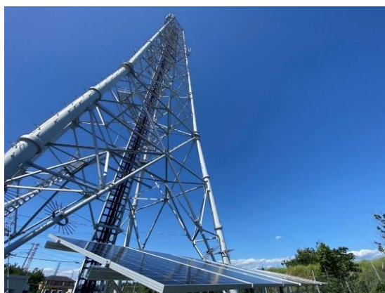
＜サステナブル基地局＞
